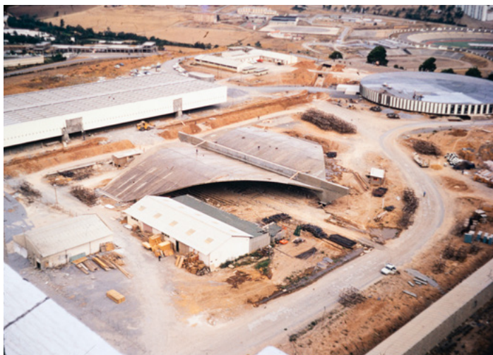
FIG. 3: Auditório da Universidade de Constantine em construção. Fonte: Fotografia em slide cedida por Cecília Saliture, 1970-1975.
