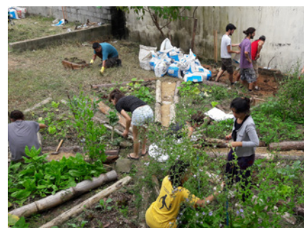
FIG. 1 E 2: Manejo dos jardins filtrantes em 2018 (eletivas Manejo das Águas & Edifício Sustentável). Fonte: Foto de Luis Octavio de Faria e Silva/Acervo Plataforma Arquitetura e Biosfera.
